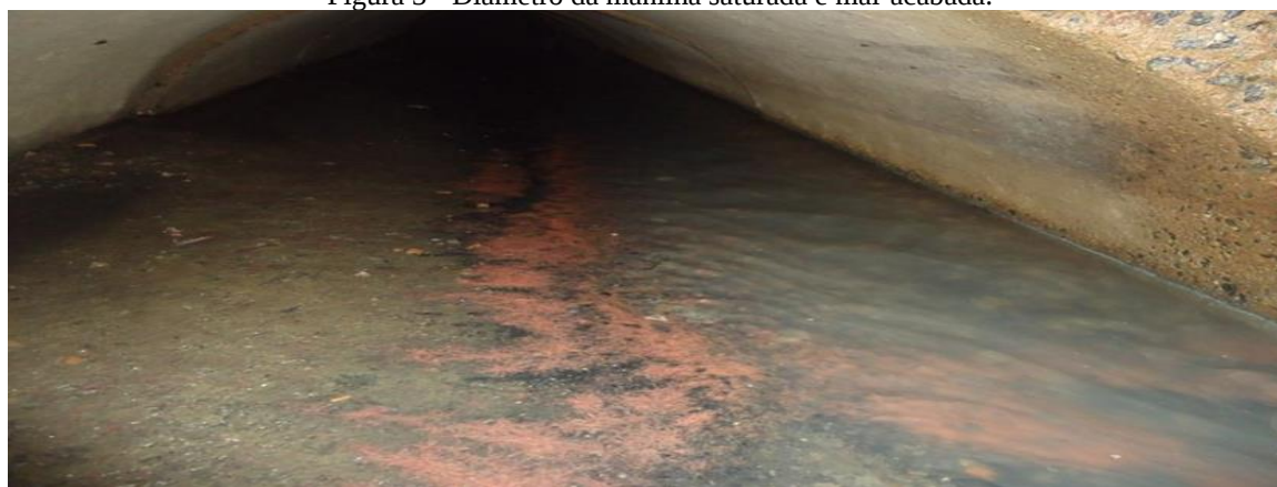
Figura 3 - Diâmetro da manilha saturada e mal-acabada.
